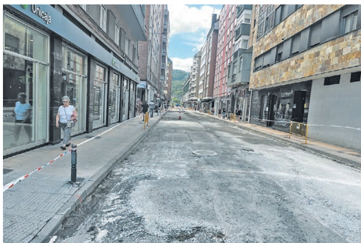
Estado que presenta la Calle del Norte.
