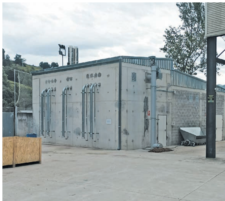
Nueva sala de calderas centralizadas alimentadas por biomasa que dará servicio de calefacción a varios edificios del municipio.
