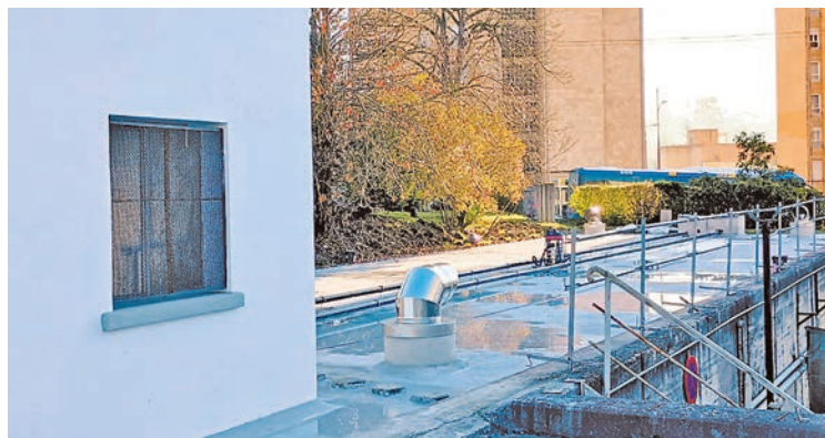
Depósitos de agua del Hospital Valle del Nalón tras su renovación.
